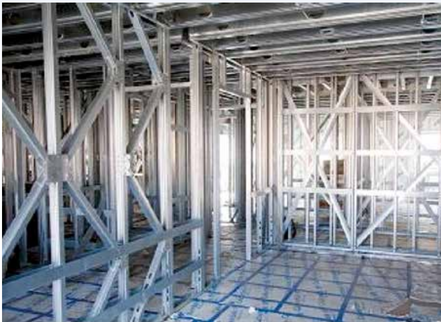
Рисунок 4.2 Блочный монтаж связевого каркаса из тонкостенных стальных профилей в жилом здании Fusion Building Systems
