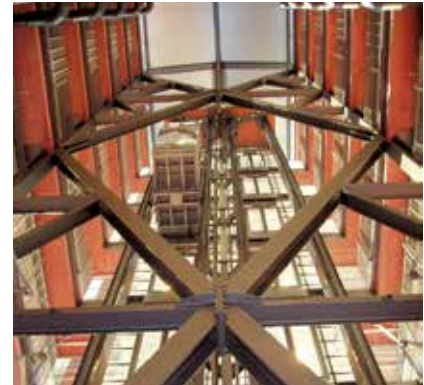
Рисунок 51. Вертикальная связевая ферма каркаса в атриуме многоэтажного здания Arcelor Mittal, Люксембург, с элементами двутаврового сечения, архитектурное бюро Böhm, конструктивный проект Schroeder & Associés
