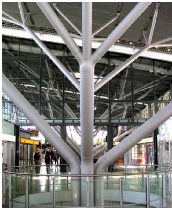
Рисунок 89. Стальные колонны аэропорта, Штутгарт, Германия, с разветвленными капителями оголовков для распределенного поддержания перекрытия, проект бюро von Gerkan, Marg und Partner, 2004 год
