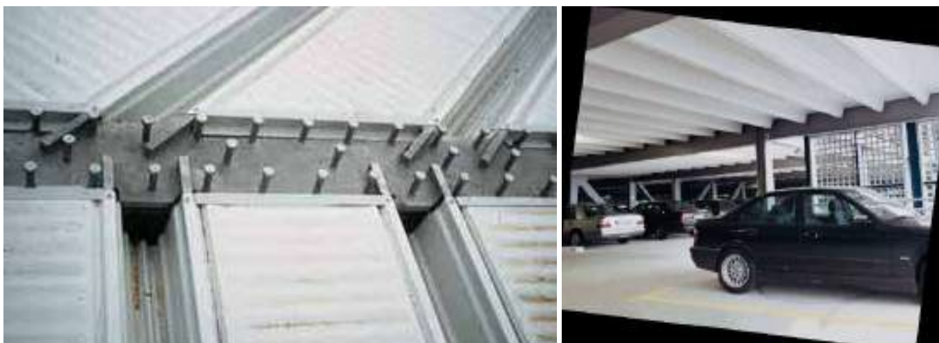
Рис. 3.5. Плити із застосуванням трапецієвидного оцинкованого настилу, який спирається на сталеві столики, що приварюються до верхніх поясів балок, вигляд у збудованому паркінгу:
