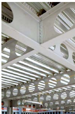
Рисунок 126. Болтовое соединение второстепенной и главной перфорированных балок равной высоты с подрезкой полки
