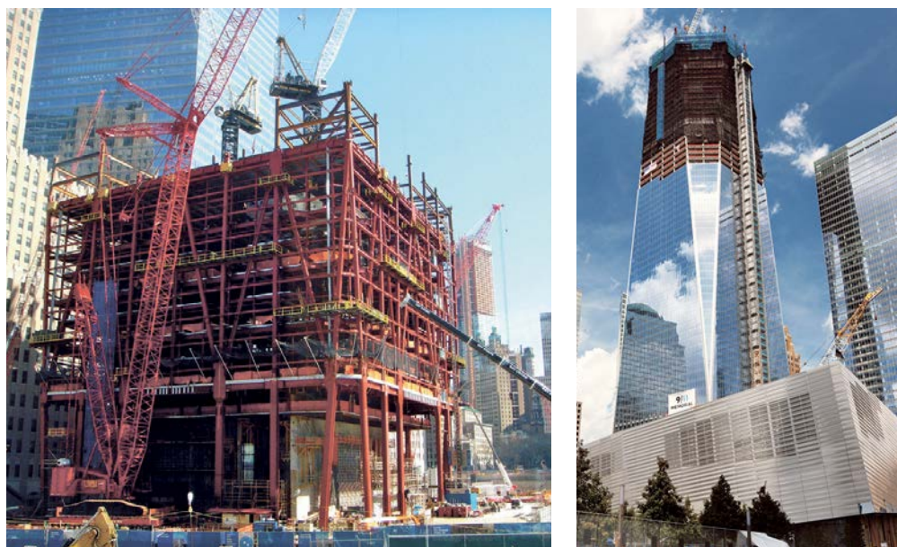
Рисунок 82. Ферма-аутригер высотой в несколько этажей, позволяющая разредить сетку колонн входной группы нового здания Всемирного Торгового Центра, Нью-Йорк, США, архитектор David Childs (бюро Skidmore, Owings & Merrill), конструктивный проект бюро WSP Cantor Seinuk, 2014 год
