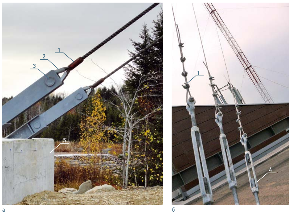
Рисунок 112. Детали крепления вант: 1 - зажим; 2 - коуш; 3 - устройство фиксации натяжения; 4 - талреп; 5 - фундамент с опорной базой
