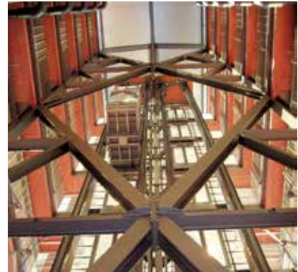
Рисунок 51. Вертикальная связевая ферма каркаса в атриуме многоэтажного здания Arcelor Mittal, Люксембург, с элементами двутаврового сечения, архитектурное бюро Böhm, конструктивный проект Schroeder & Associés
