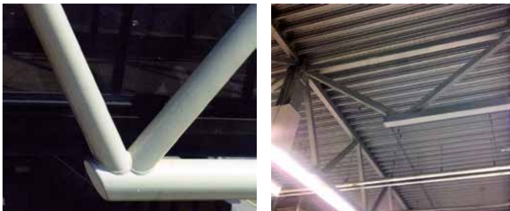
Рисунок 120. Крайние узлы примыкания раскосов к нижнему поясу в бесфасовочных фермах из труб и гнутосварных замкнутых профилей
