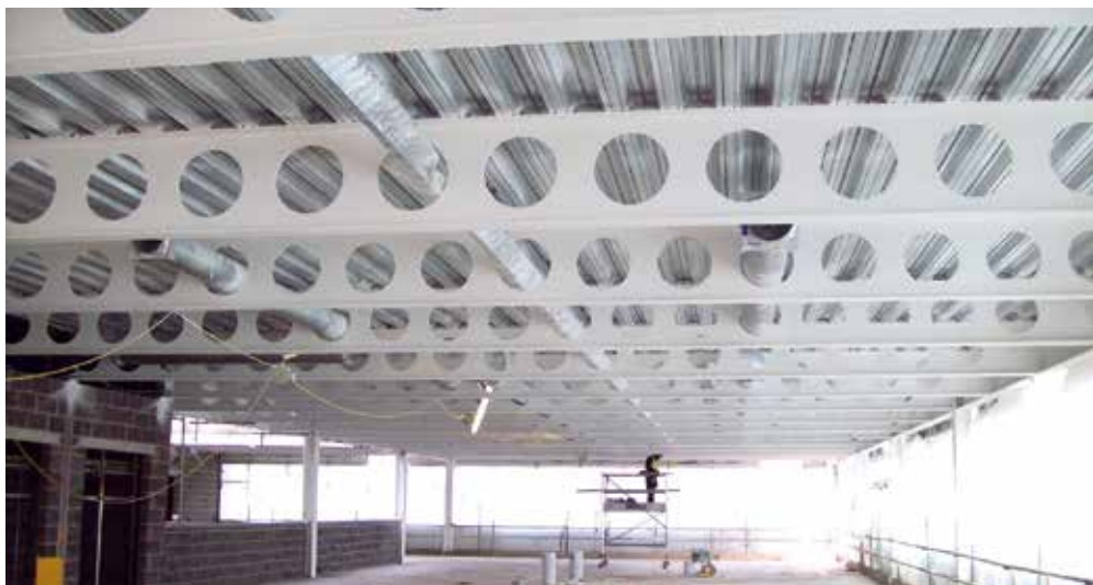
Рисунок 172. Внешний вид балочного композитного перекрытия с нанесенным огнезащитным покрытием
