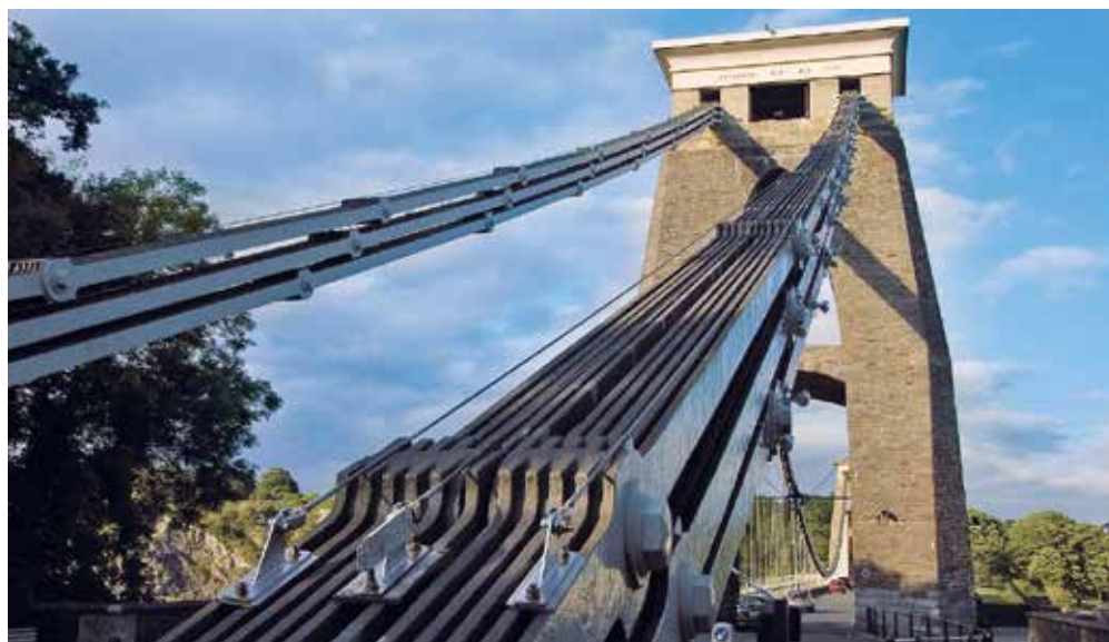
Рисунок 113. Опорный узел примыкания жестких вант из стальных листов моста Clifton в Бристоле, Англия
