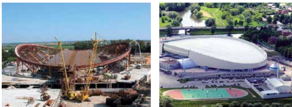
Рисунок 42. Мембрана, подкрепленная вантами покрытия главного зала стадиона, 90x87 м, Ангарск, Российская Федерация, архитектура «Сибирский «Оргстройпроект», конструкторив «Курортпроект», 2006 год
