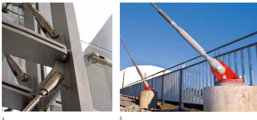
Рисунок 109. Узлы примыкания канатов с проушинами и муфтами: а - элементов связей к стойке фасада; б - оттяжек к опорной базе фундамента
