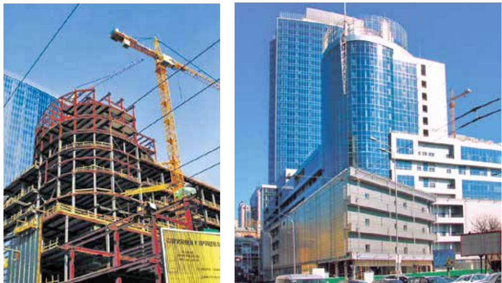
Рисунок 31. Компоновка балок перекрытий и внешний вид торгово-офисного центра Gulliver, Киев, Украина, архитектор Татьяна Григорова, конструктив Украинский институт стальных конструкций имени В.Н. Шимановского, 2013 год
