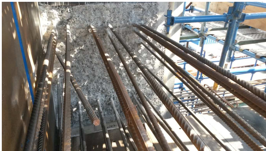
Рис. 4. № 3 Смещения арматурных выпусков балок
